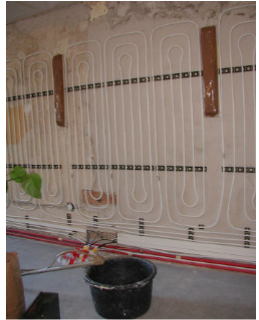
6 Die vorgefertigten Wandheizungsregister aus Kunststoff-Metall-Verbundrohr sind auf Befestigungsschienen vormontiert.
